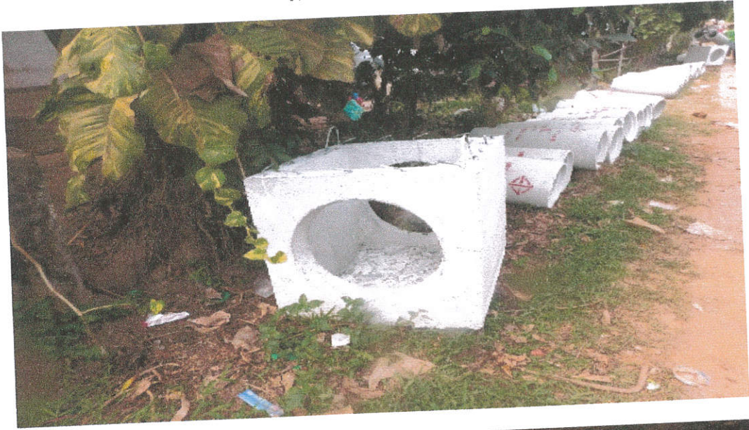
โครงการลงท่อระบายน้ำบ้านเชียงพัง หมู่ที่ ๓ เส้นจากบ้านนางชวนพิศไปบ้านนายสวน ชาวสวน บ้านเชียงพัง หมู่ที่ ๓ ตำบลนากว้าง อำเภอเมือง จังหวัดอุดรธานี ภาพขณะดำเนินการ
